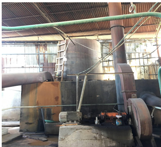
锅炉及除尘设施
