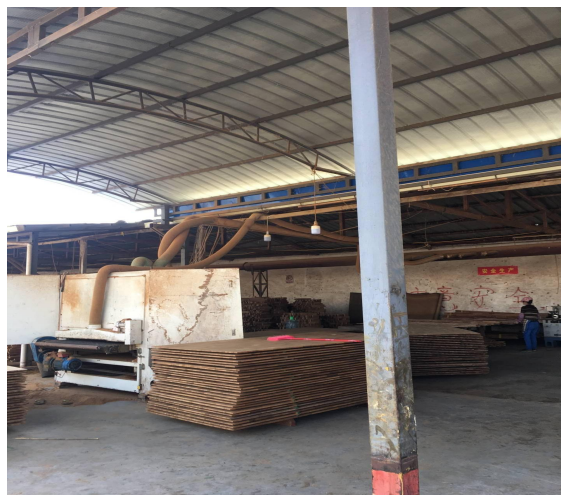
生产区管道收尘设施
